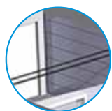
Tuyauterie de réfrigérant (et boîtier BS*)
