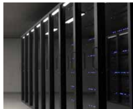
Refroidissement de data-centers
